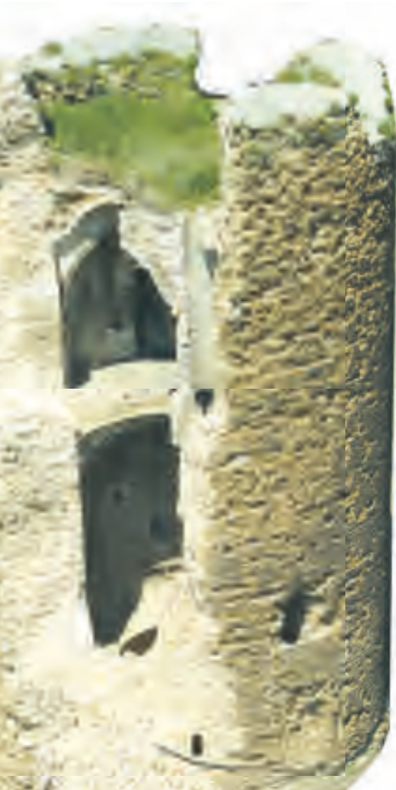
Figure 2. La Tour des Vierges de Zichem, après l'effondrement partiel survenu le 1 er juin 2006 (photo VLM).
