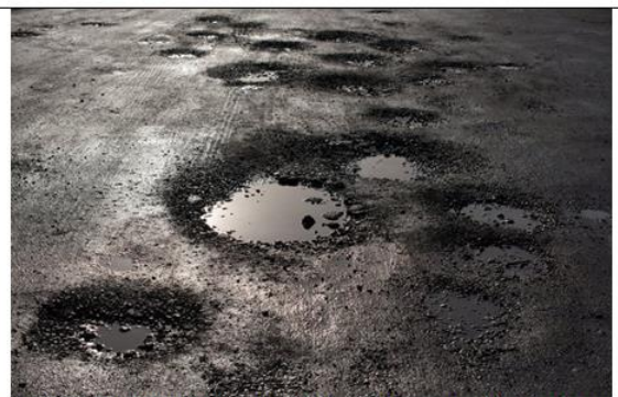
Figuur 2. Voorbeeld van zoutschade aan wegen en bruggen (Foto via Shutterstock )
