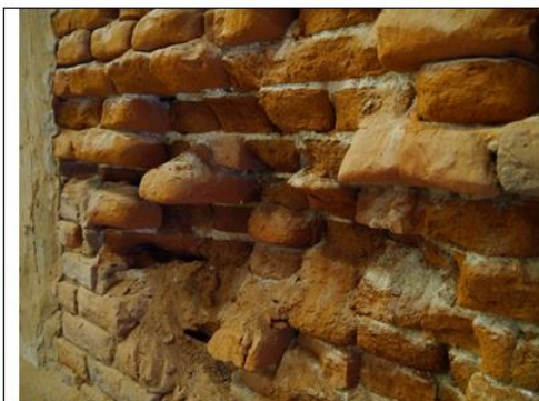
Figuur 1. Voorbeeld van zoutschade aan historisch metselwerk (Foto KIK-IRPA, Hof te Bree-Eik in Lennik , België)
