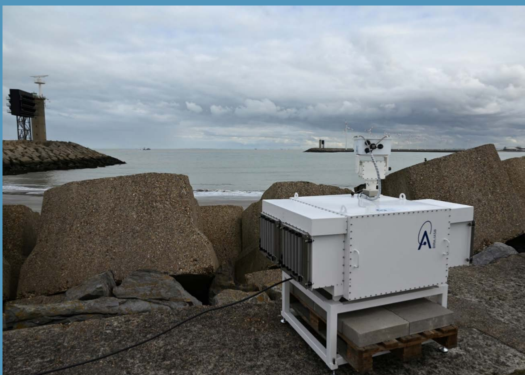
Het SEMPAS-instrument in de haven van Zeebrugge tijdens de testfase.
